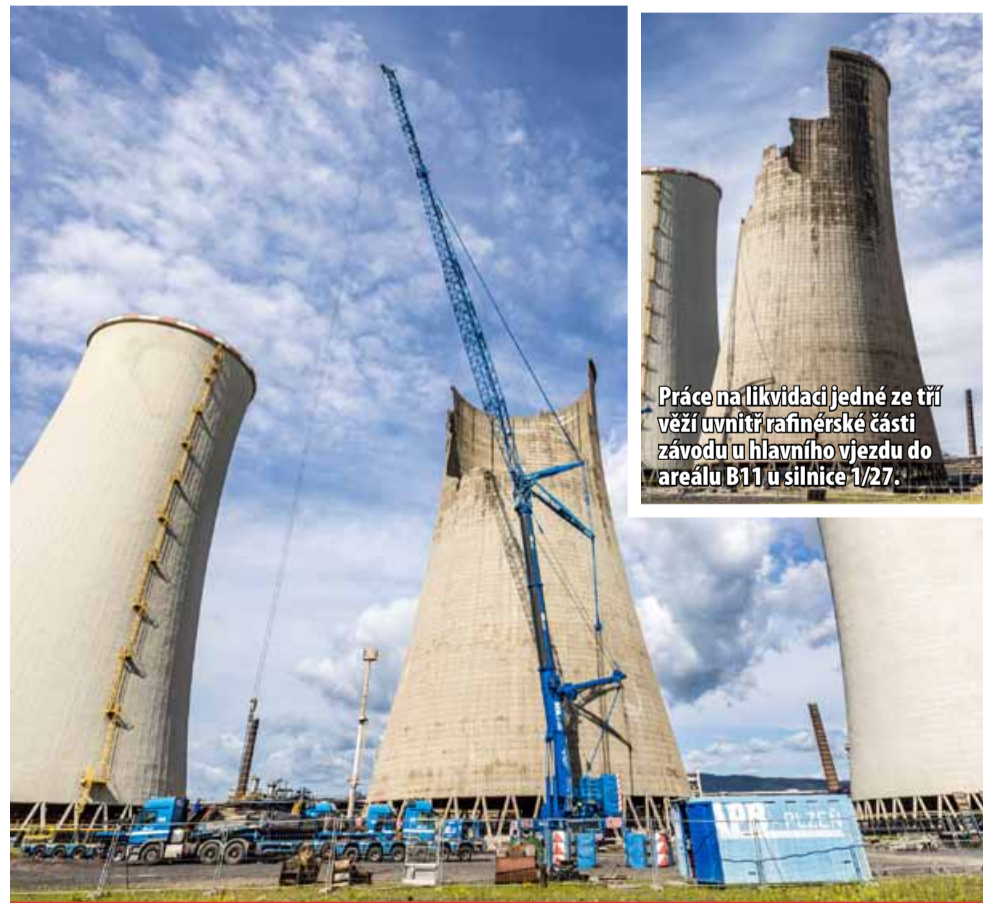
K zemi půjdou dvě z celkem osmi chladicích věží.
