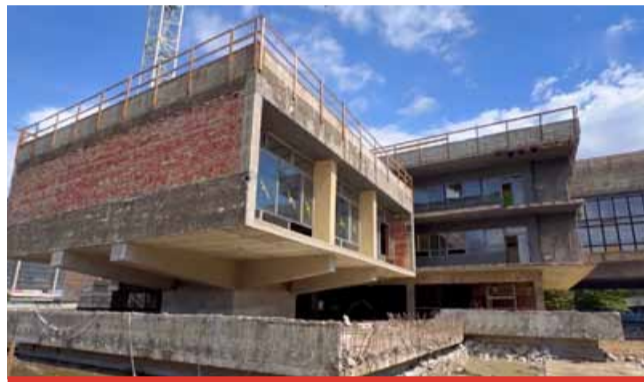
Při práci se odhaluje nejen azbest, ale i jakým ledabylým způsobem se Repre v letech 1972 až 1984 stavělo. Stavba nebyla vždy provedena zcela kvalitně a dělníci kdysi značně improvizovali.
